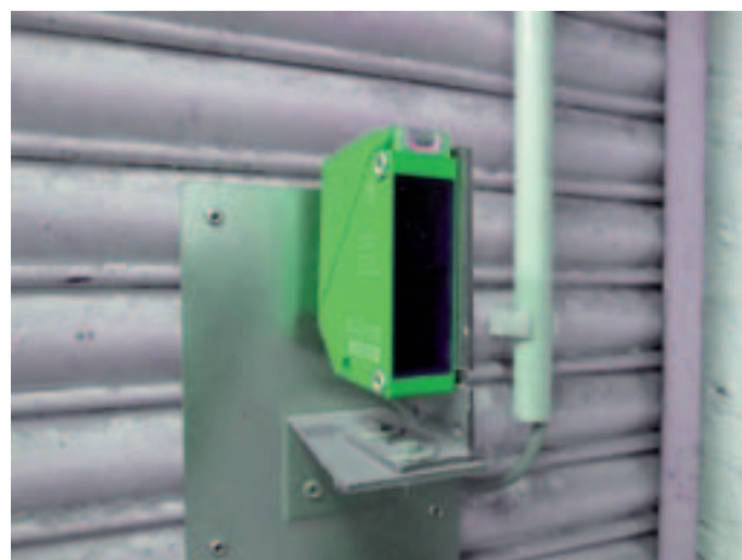
Bild 3: Lichtschranke, wie sie heute in vielen Fällen entsprechend DIN EN 12453 vorgeschrieben ist, aber an älteren Toren oft fehlt Fotos: BVT
